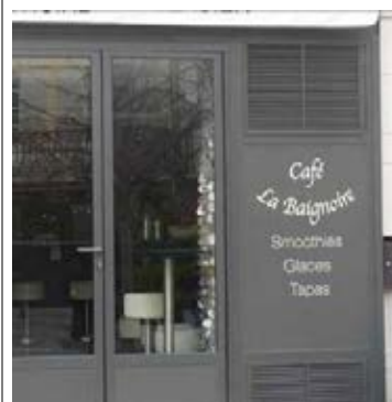
climatiseurs derrière des panneaux ajourés
