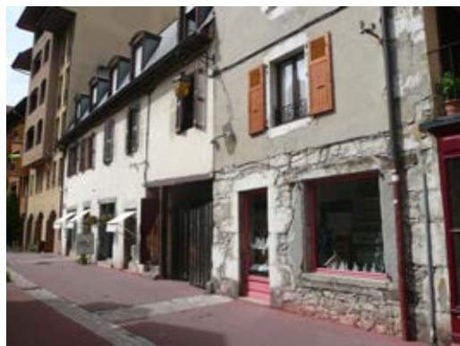
Le décroûtage est interdit
