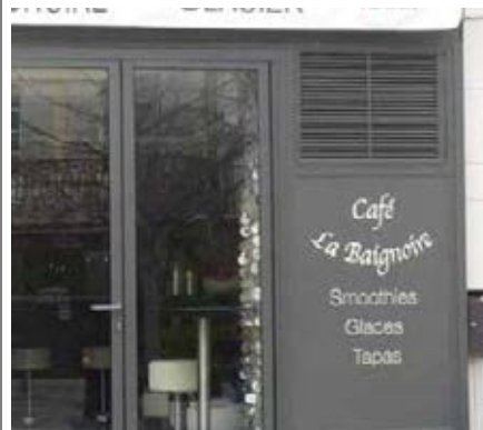
climatiseurs derrière panneaux ajourés
