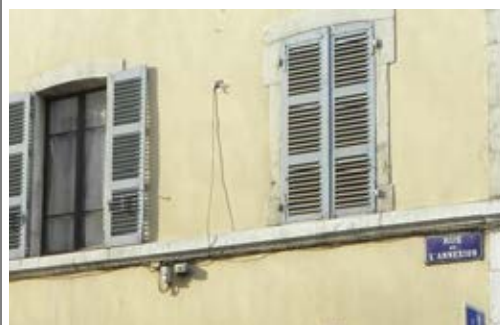
Les réseaux électricité et téléphone encombrant la façade
