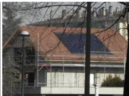
Recherche d'équilibre symétrique dans l'installation des ces panneaux
