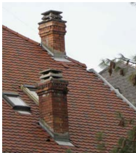
Conservation d'anciennes souches de cheminée qui ont été adaptées aux dispositifs d'extraction récents
